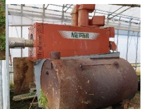
ハウスの暖房設備
