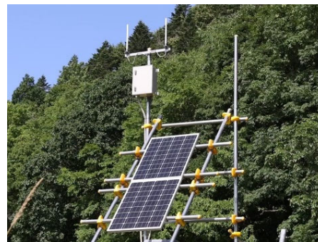
LPWA (LoRaWAN®) 基地局
