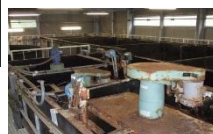
老朽腐食した処理設備
