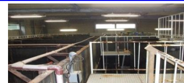
廃水処理棟内全景
