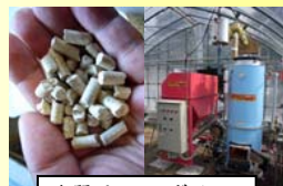
木質ペレット・ボイラー
