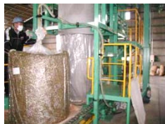
TMRセンター(プラント)
