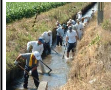
水路の共同管理
