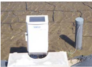
自動給水栓の導入
