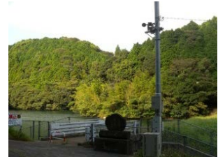
水位計や監視カメラの設置
