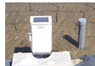
自動給水栓の導入
