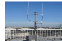
通信施設の整備
