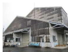
老朽化した施設
