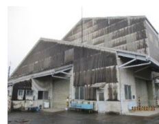
老朽化した施設
