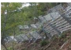
なだれ防止施設
