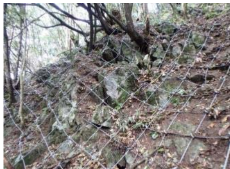
【ネットによる落石の防止】 (島根県津和野市)
