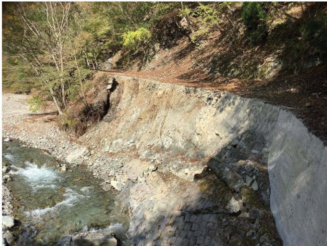
写真 3-1 林道被害箇所全景
