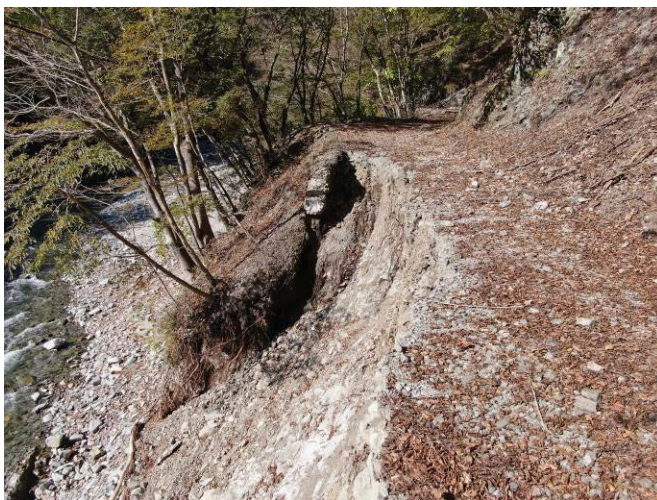
写真 3-2 林道被害箇所の路肩の状況
