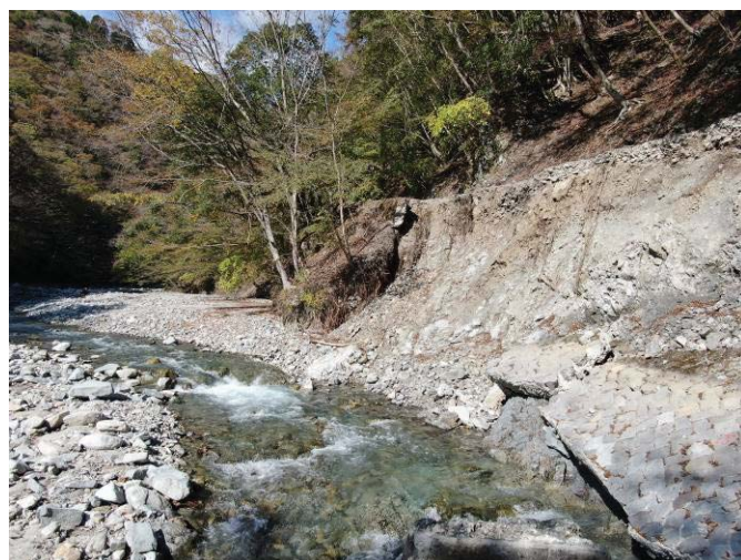
写真 3-3 林道被害箇所の溪流部の状況
