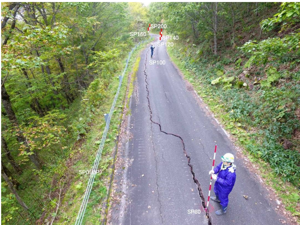
写真 2-6 平成 30 年災害 北海道 舗装工の被災
