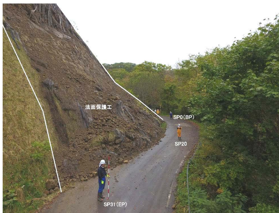
写真 2-1 平成 30 年災害 北海道 法面崩壊
