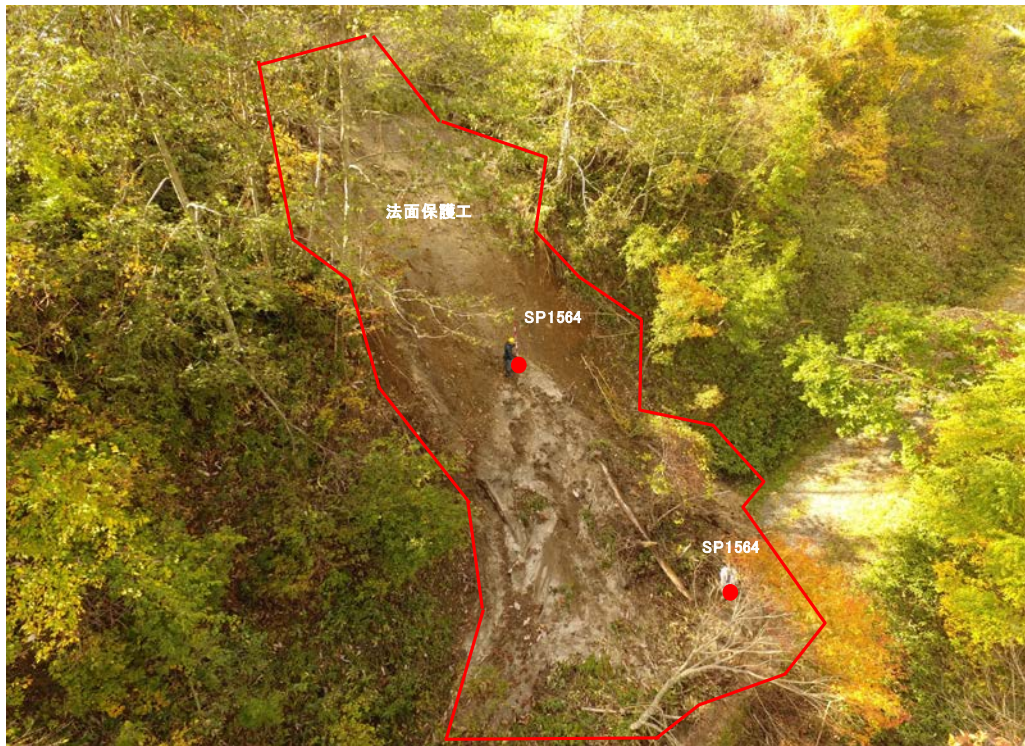
写真 2-3 平成 30 年災害 北海道 法面崩壊
