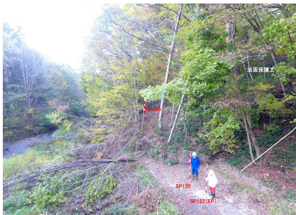
写真 2-2 平成 30 年災害 北海道 法面崩壊
