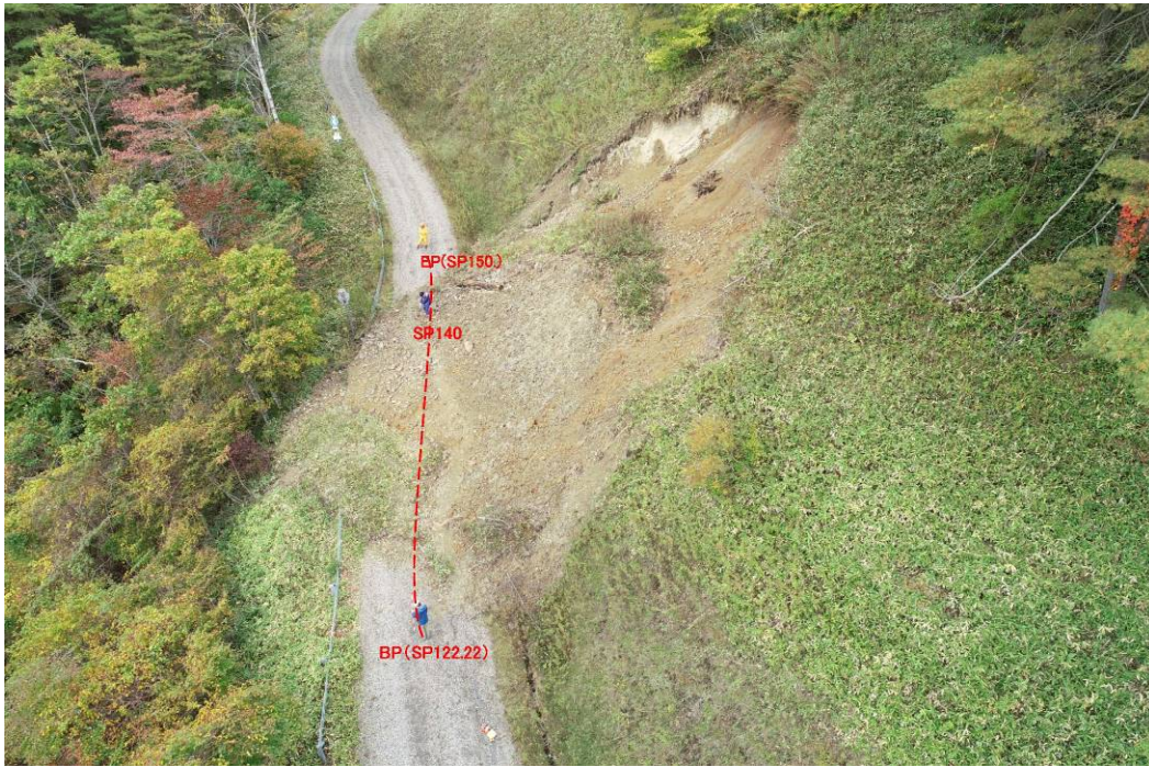
写真 2-5 平成 30 年災害 北海道 法面崩壊
