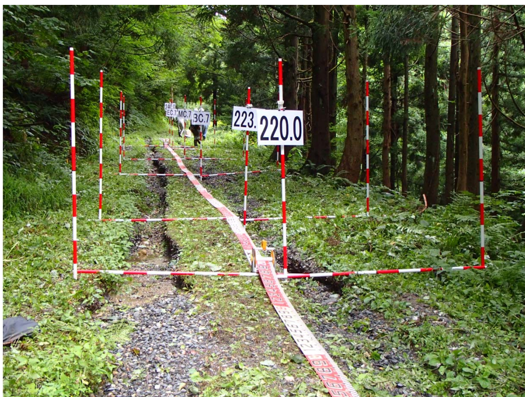
写真 2-10 平成 29 年災害 新潟県 路面水の集中流下
