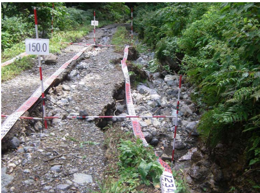
写真 2-9 平成 23 年災害 新潟県 路面水の集中流下
