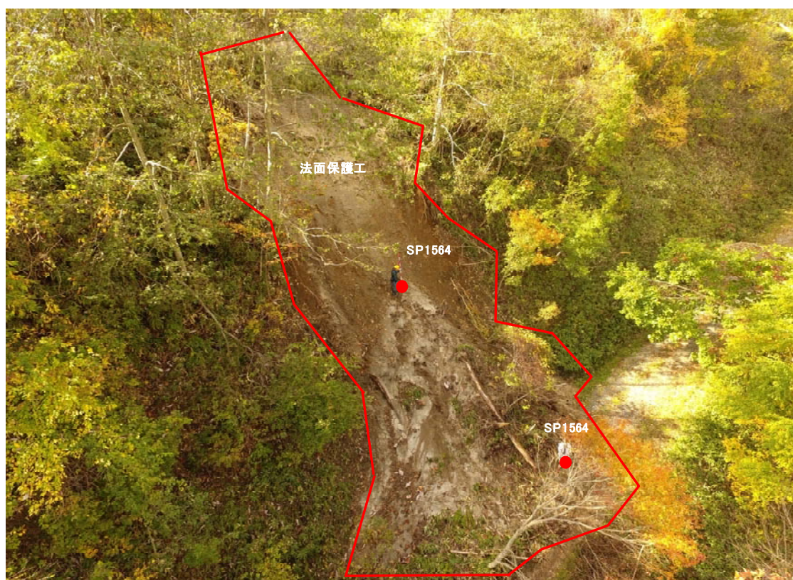
写真 2-2 平成 30 年災害 北海道 地震動による法面崩壊
