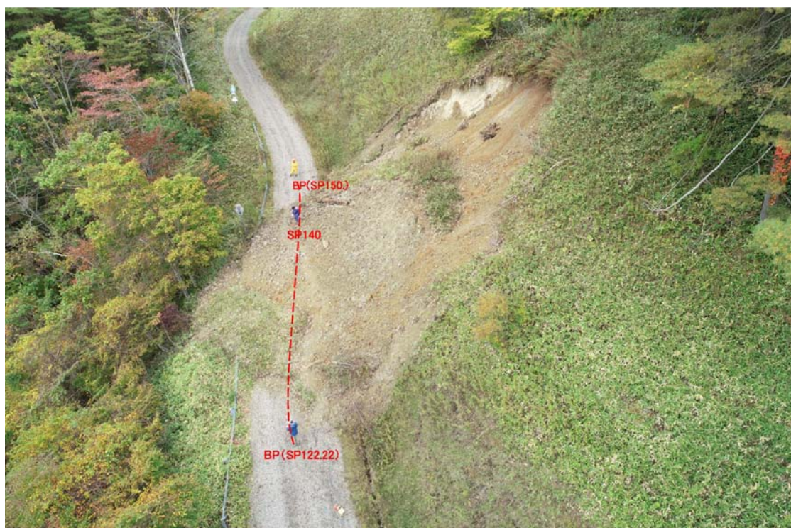
写真 2-1 平成 30 年災害 北海道 浸透水の飽和による法面崩壊
