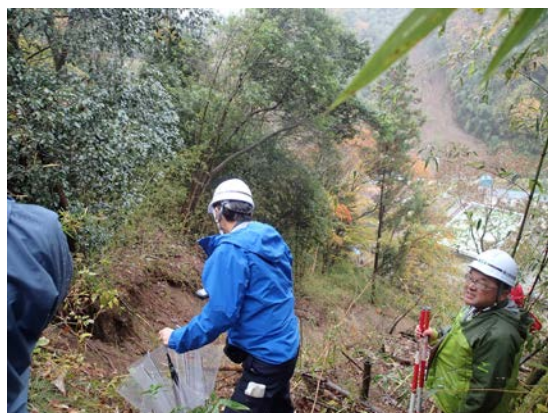
(斜面滑落崖の確認)
