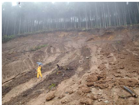
(斜面上部の滑落崖)
