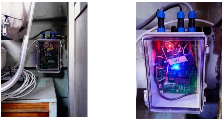
図 33-5 左図 : ロガー設置状況、右図 : ロガー稼働状況 (赤ランプ点滅から点灯へ)
