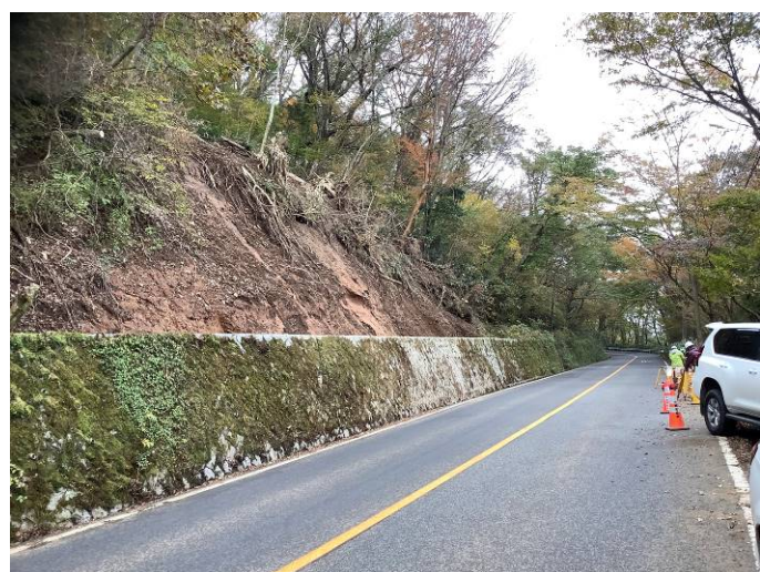
写真 3-8 崩壊地直下の県道の状況
