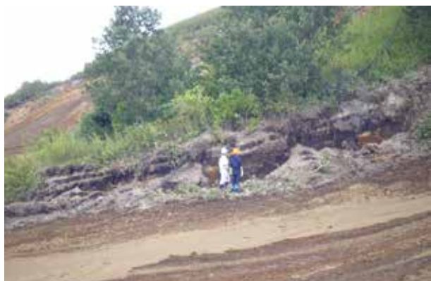
谷地形崩壊箇所の側壁
