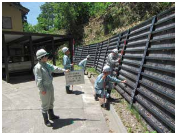
危険地域の点検（石川県金沢市）
