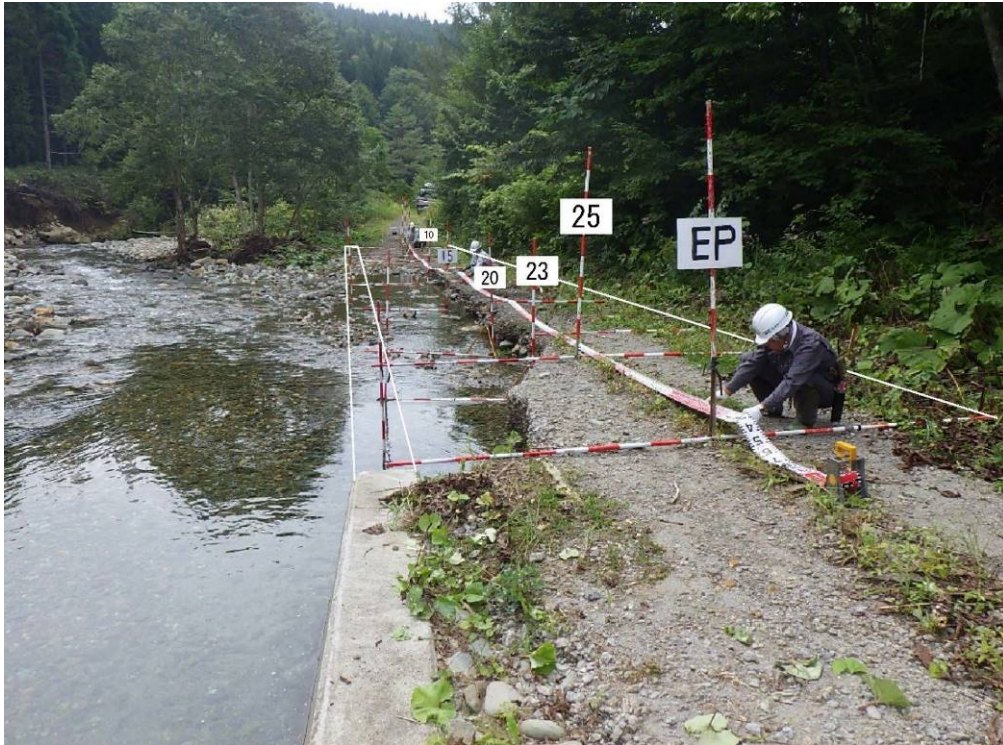
写真 2-11 平成 29 年災害 秋田県 路体侵食
