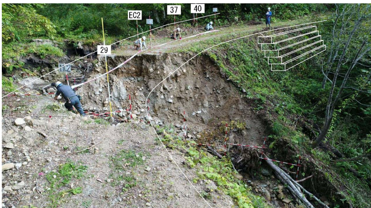
写真 2-10 平成 29 年災害 秋田県 溪流部における路体流出
