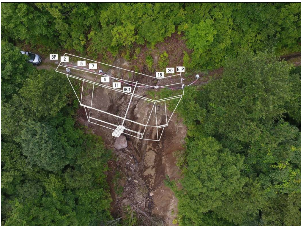
写真 2-12 平成 29 年災害 秋田県 路体崩壊
