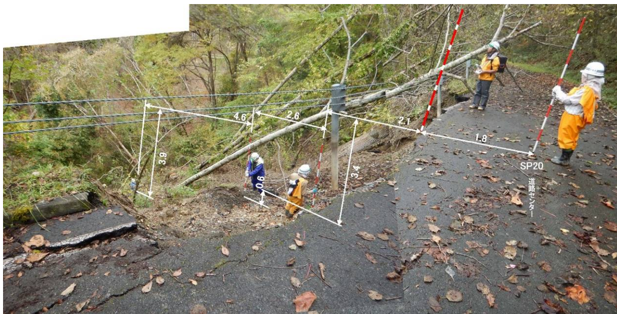
写真 2-9 平成 30 年災害 北海道 路肩部の崩壊
