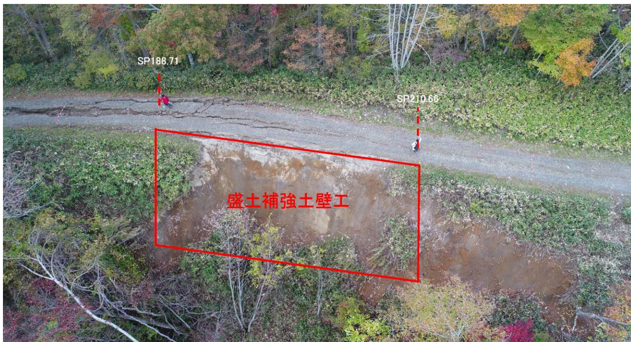
写真 2-7 平成 30 年災害 北海道 路肩部の崩壊
