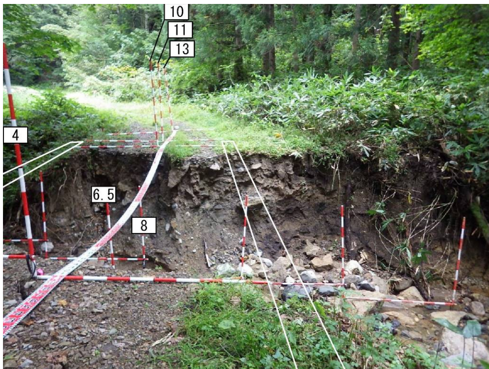
写真 2-15 平成 30 年災害 秋田県 排水施設の流出
