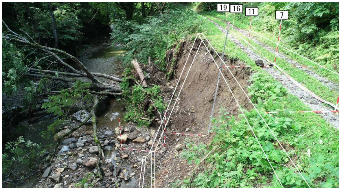
写真 2-14 平成 30 年災害 山形県 路肩崩壊
