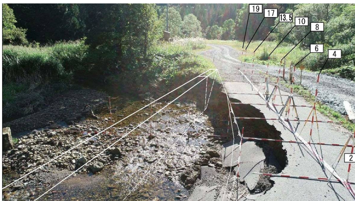
写真 2-16 平成 30 年災害 秋田県 路体侵食
