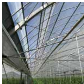
谷換気・天窓
