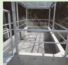
ファイバーボール脱臭装置 既存脱臭槽利用型
