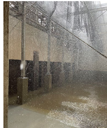
脱臭槽内 (上部から散水 (循環利用))
