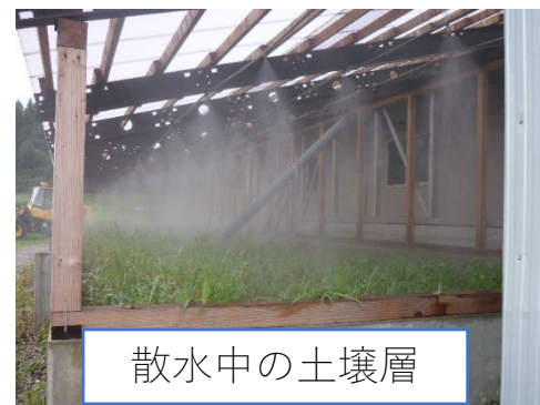
土壌脱臭装置
