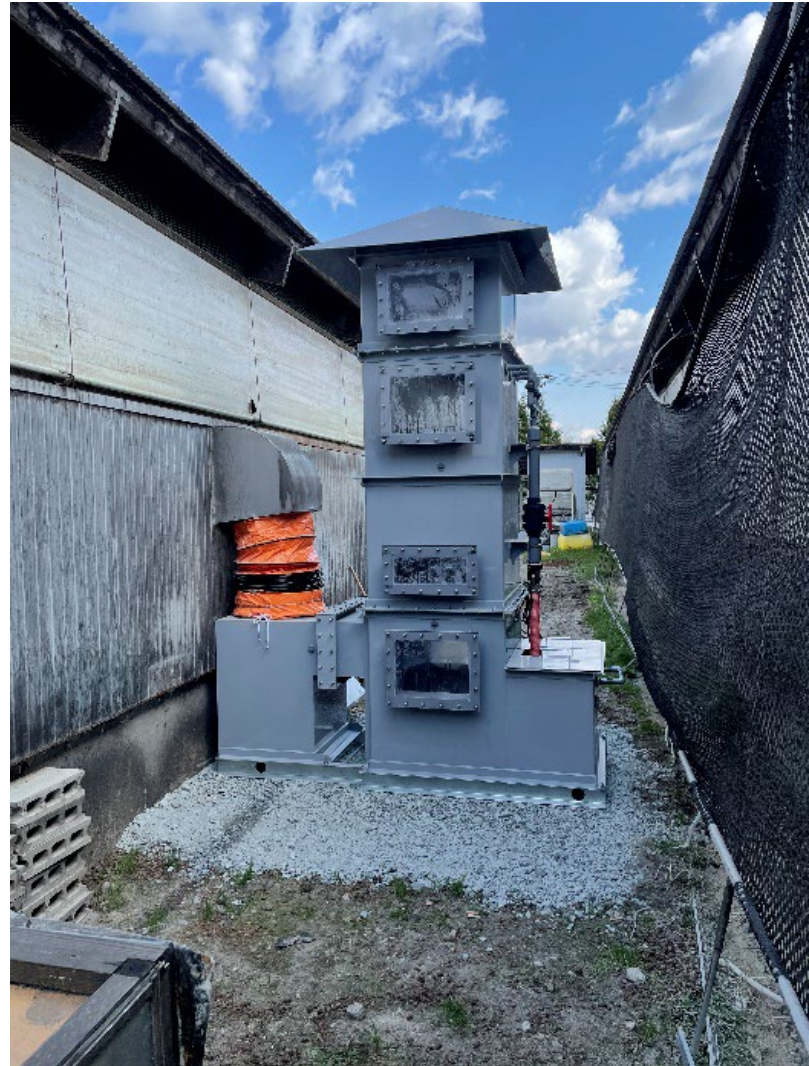
スクラバー方式による脱臭システム
