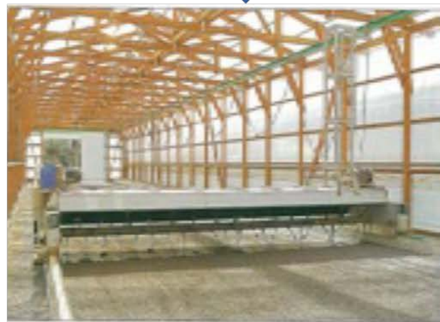
攪拌機付き温風乾燥設備
