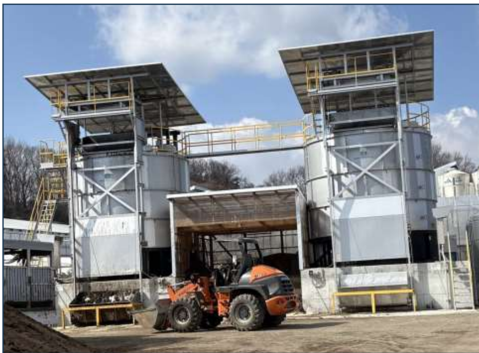
縦コンから軽石脱臭装置へ排気 (脱臭槽の大きさは、縦15m×横8m×高さ2.5m=約300m 3 )
