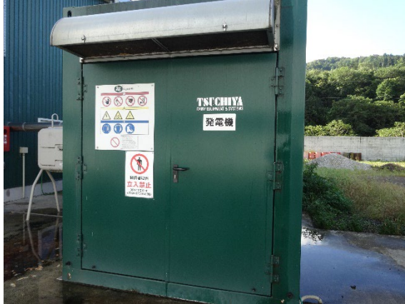
ガスエンジン、発電機が入る。 海上コンテナを少し小さくした位の大きさ。
