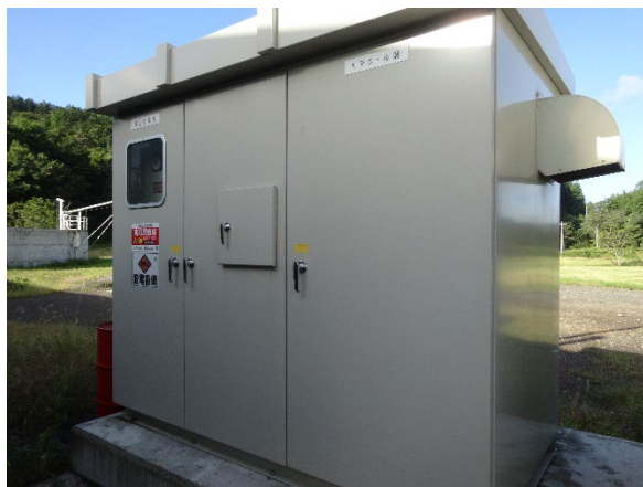
変電設備。400⇒6,000Vへ昇圧。
