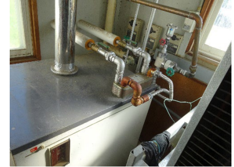
灯油ボイラー上部に設置された熱交換器
