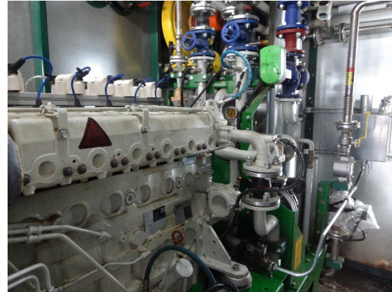
ガスエンジンと排熱回収部。排気量8,000 c c 軽油等は利用できない。点火プラグ付。
