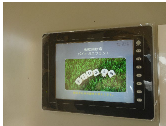
プラント操作パネル。 インターネット接続され遠隔監視、操作可。
