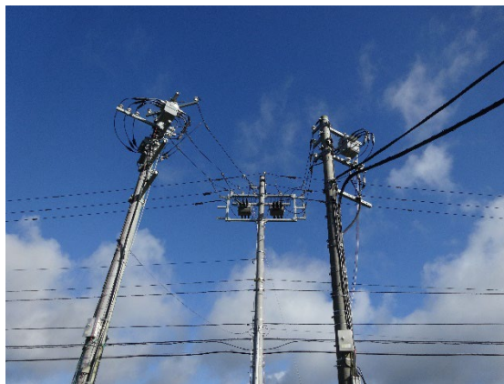
北海道電力の送電線への接合部。 左電柱が売電側。右は買電。
