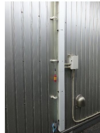
ガスバッグの膨らみに応じて赤の指標が上下し これを検知して発電出力の自動制御を行う。
