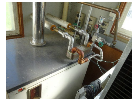
灯油ボイラー上部に設置された熱交換器
