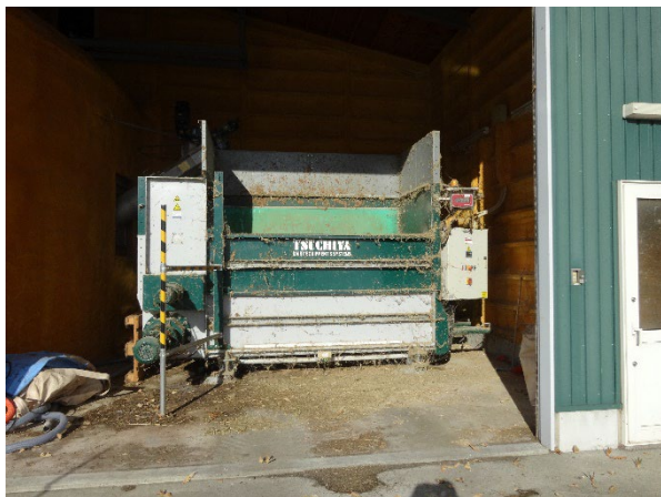
残餌投入装置。発酵槽内液面最上部に投入し、スカム層を作り、硫黄細菌を繁殖させる。
