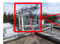
外付け型膜分離装置による高度な浄化処理
