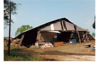
地震により倒壊した畜舎
