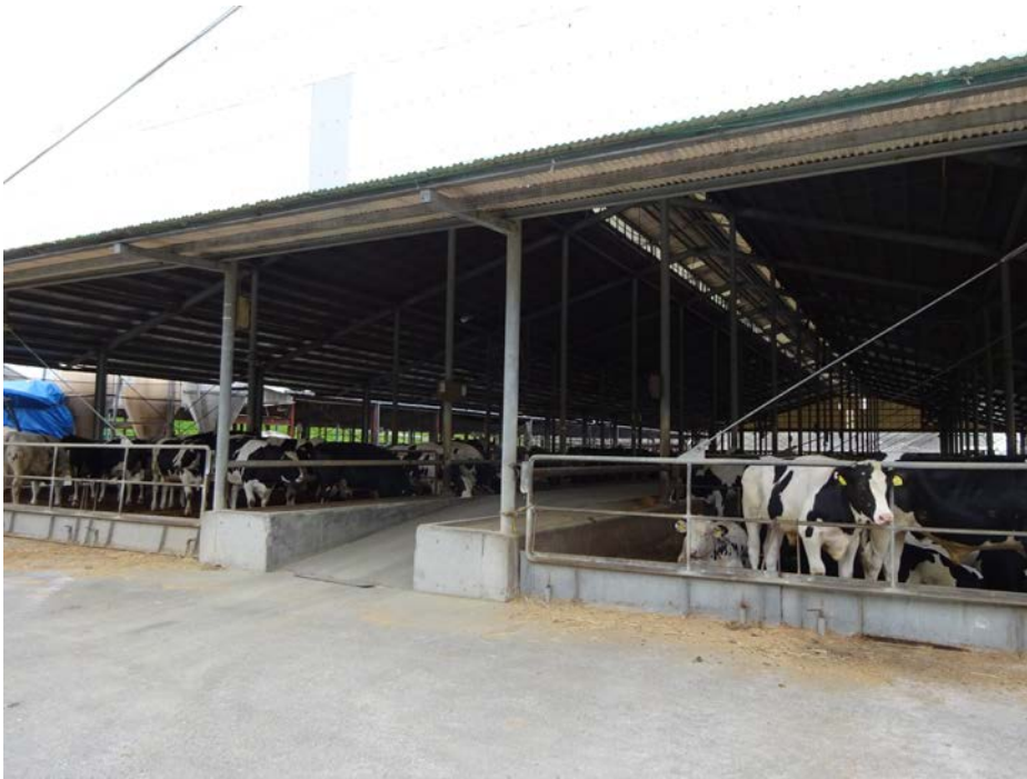
（被害を免れた鉄骨牛舎） 御船町（震度6弱）
