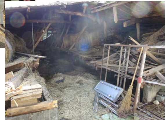
主要構造部の接合 部分が破損し倒壊
