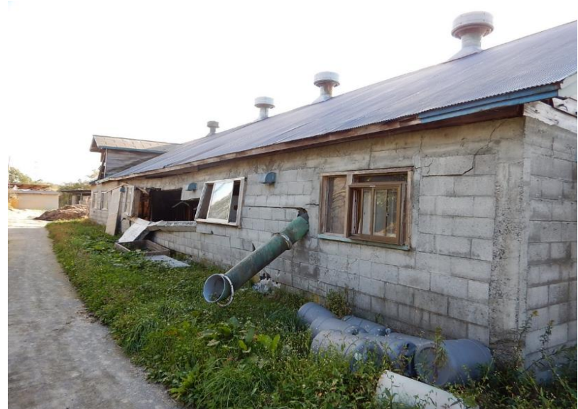
（被害を受けた牛舎） 老朽化により壁面が地震で損傷
