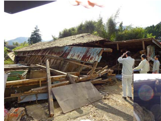
柱が崩落し倒壊した牛舎 阿蘇市（震度6弱）
