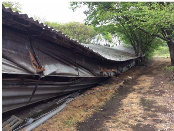
（倒壊豚舎） 屋根部分を残して 倒壊した豚舎 西原村（震度7）
