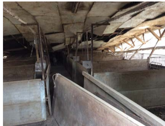
主要構造部の接合 が損害を受け倒壊
