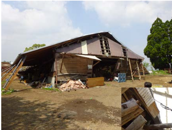
屋根部分を残して 倒壊した牛舎 西原村（震度7）
