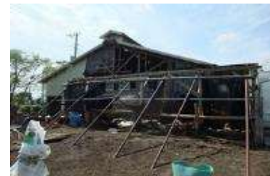
災害により倒壊した畜舎
