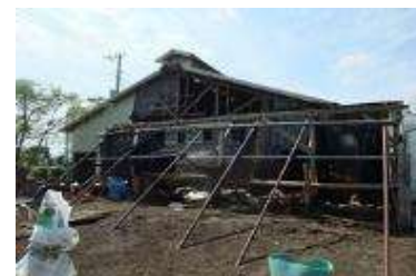
災害により倒壊した畜舎
