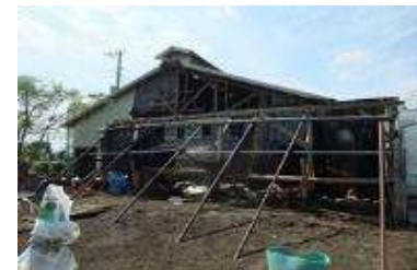
災害により倒壊した畜舎
