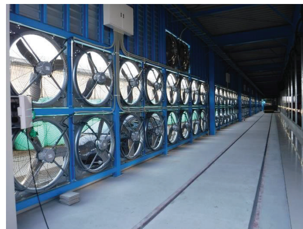
自動環境制御システムで作動する換気扇
