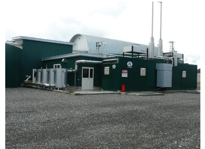
バイオガスプラント
