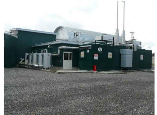
バイオガスプラント
