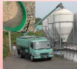
飼料保管 タンク
