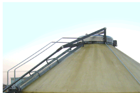
タンク蓋遠隔開閉装置
