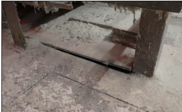
除糞ベルトの床面開口部の蓋の隙間
