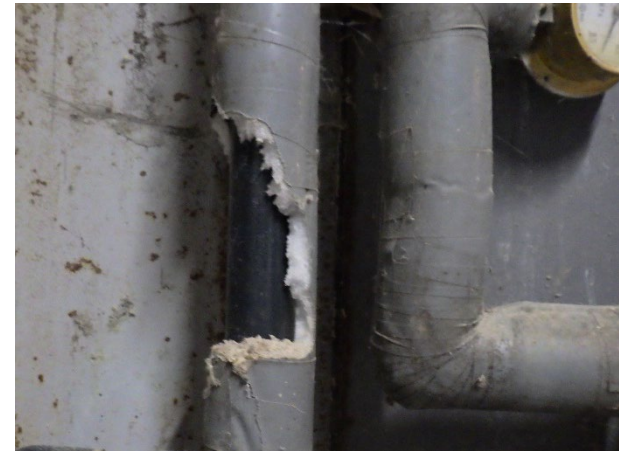
断熱材のかじり跡
