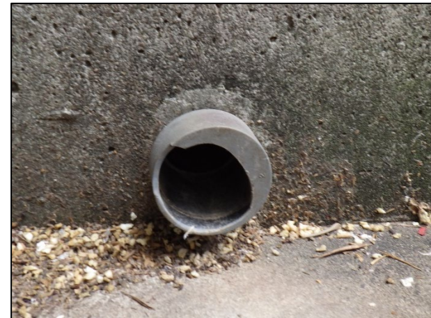
配水口の蓋の破損
