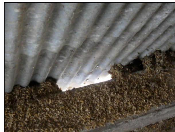
家きん舎の壁面の隙間
