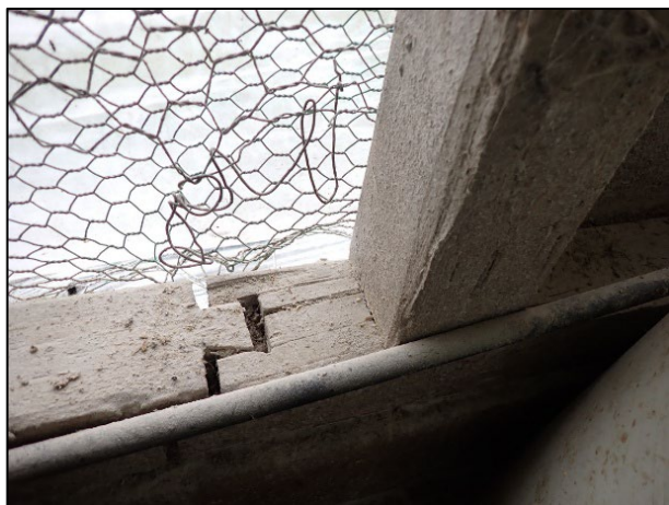
家きん舎の金網の破損
