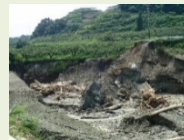
かき園地・樹体被害現場(福岡県)
