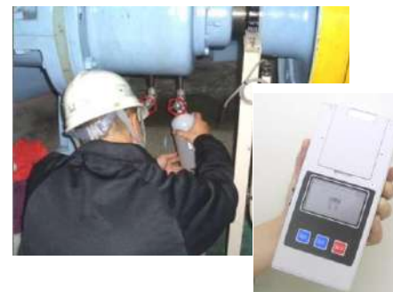
潤滑油診断によるポンプの状態監視
