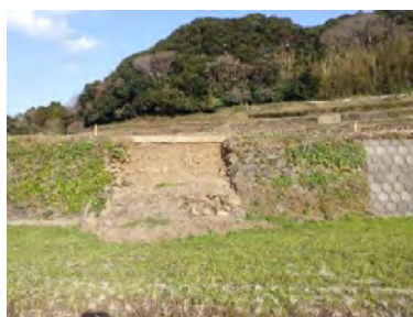
農地の被災状況
