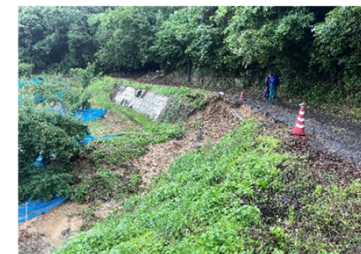
農道の被災状況
