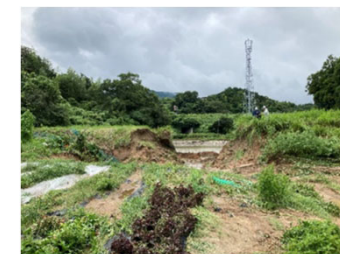
「令和7年8月5日からの大雨」により決壊したため池堤体(福岡県)
