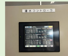
ICTを活用した環境制御装置
