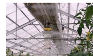
細霧冷房装置
