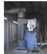
木質バイオマスボイラー
