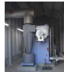
木質バイオマスボイラー
